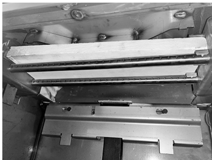
Figure 33: Panneau déflecteur installé
